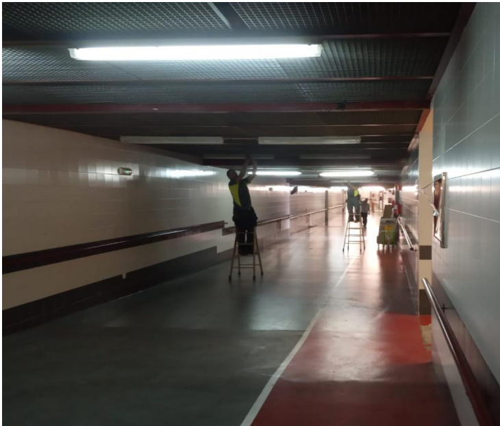
Imagen sustitución luminarias convencionales por luminarias LED en eje básico de comunicación.
