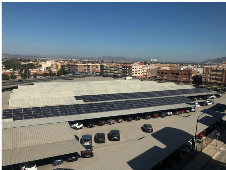
Imagen instalación solar fotovoltaica en parking de personal del HCUVA (instalación para autoconsumo).
