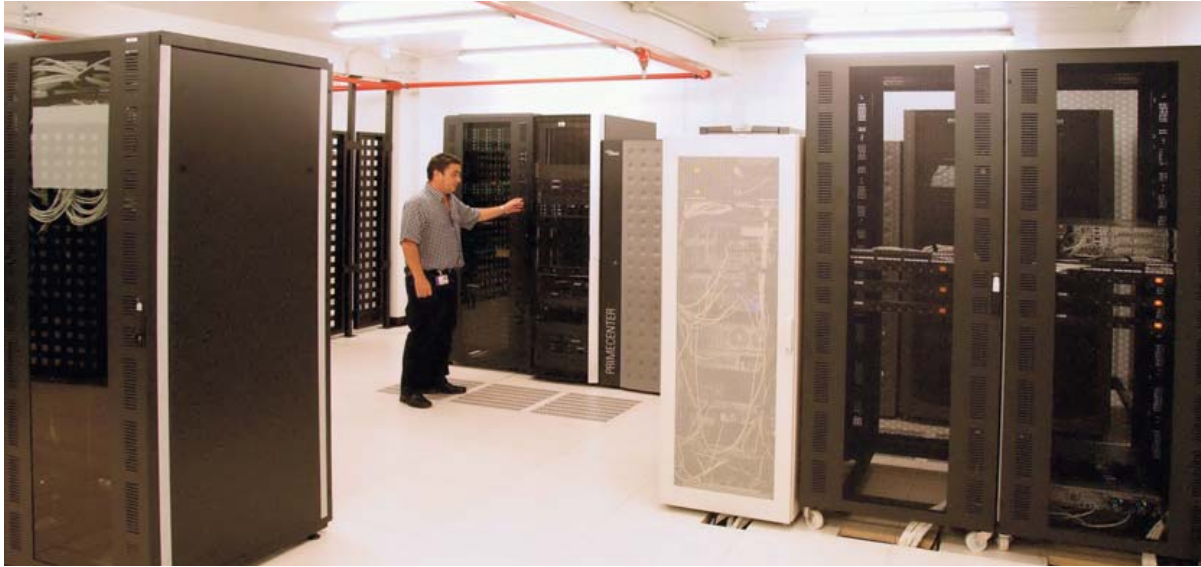
En una superficie de 70 metros cuadrados en el bloque técnico del Materno-Infantil se albergan entre 700 y 800 servidores.
