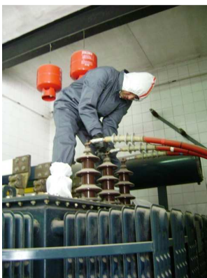
Desconexión previa a la retirada de los centros de transformación de la Arrixaca que contienen PCBs.
